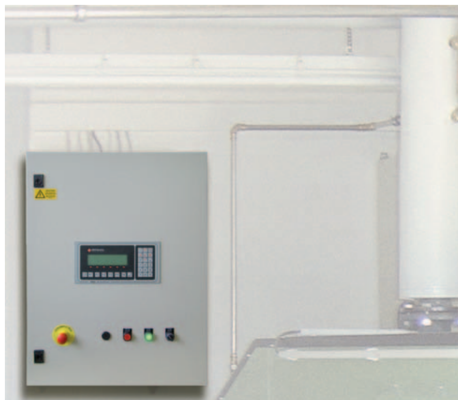
Toate componentele instalației sunt reglate automat cu comanda SPS prin panou. Stările actuale ale instalației de ardere sunt afișate pe un display luminos.
