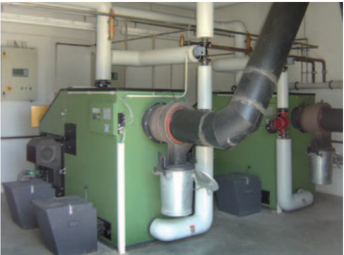
Alimentarea prin podea transportoare HDG este potrivită mai ales pentru cazurile în care este necesară o instalație de capacitate ridicată. În acest caz sistemul de alimentare este conectat la două HDG Compact 200.
